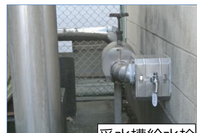
受水槽給水栓
