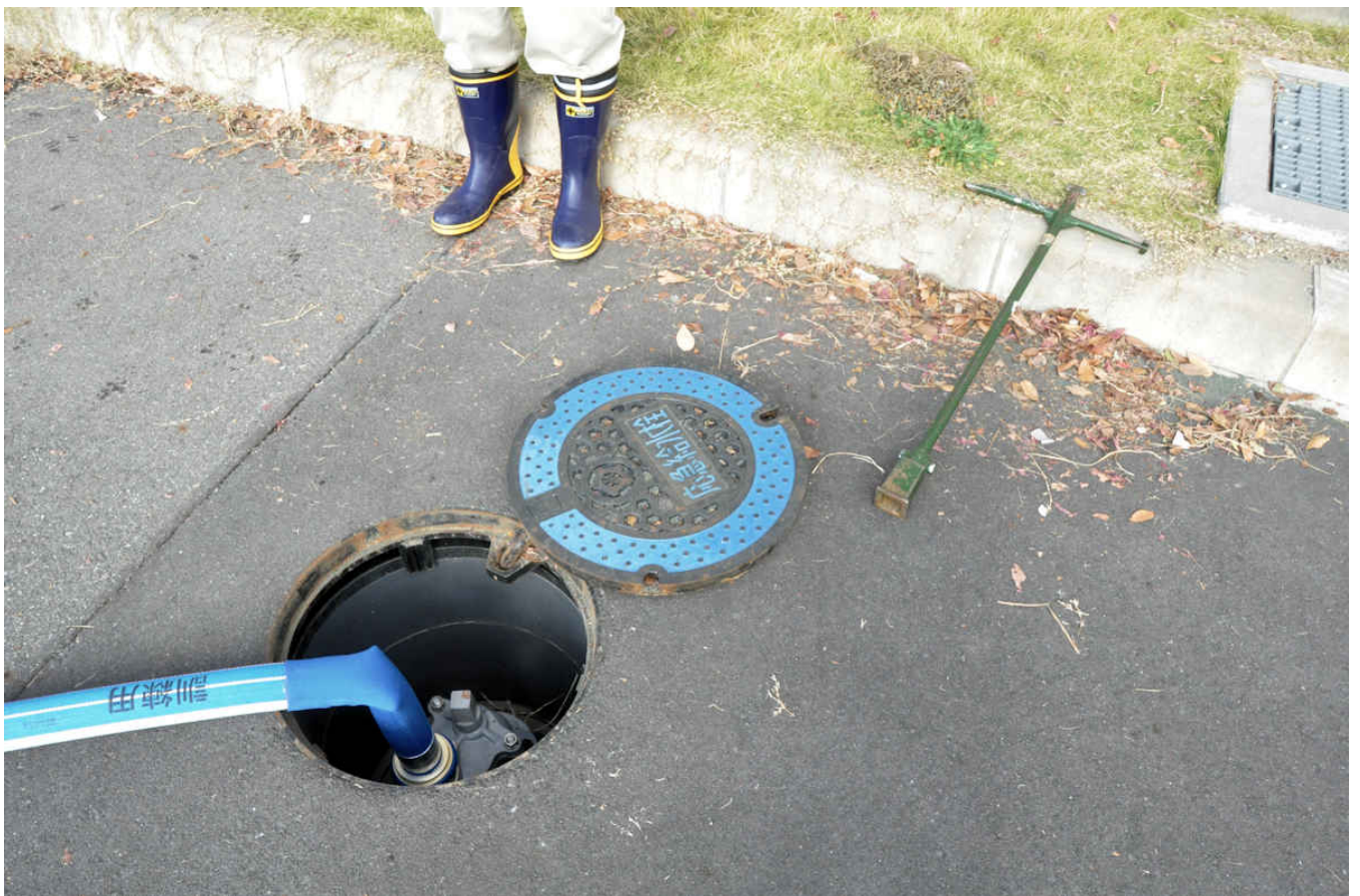
応急給水栓 一宮市の指定避難所61校中8校に設備されており、神山小学校にもある 専用の工具が必要で市職員や専門業者のみ取扱い可能
